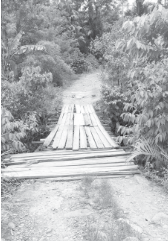
BURUK - Beginilah kondisi akses jalan dan jembatan yang buruk menuju Jorong Tombang, Nagari Sinuruik, Kecamatan Talamau, Pasbar. (arafat)
