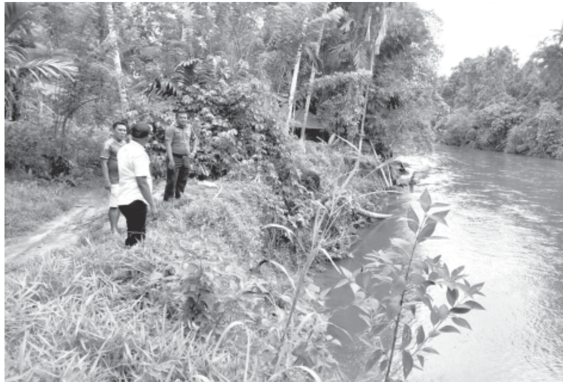
KONDISI | Hujan yang sering mengakibatkan meluapnya Sungai Manggoi sehingga runtuhnya tebing kiri-kanan. (agus suryadi)
