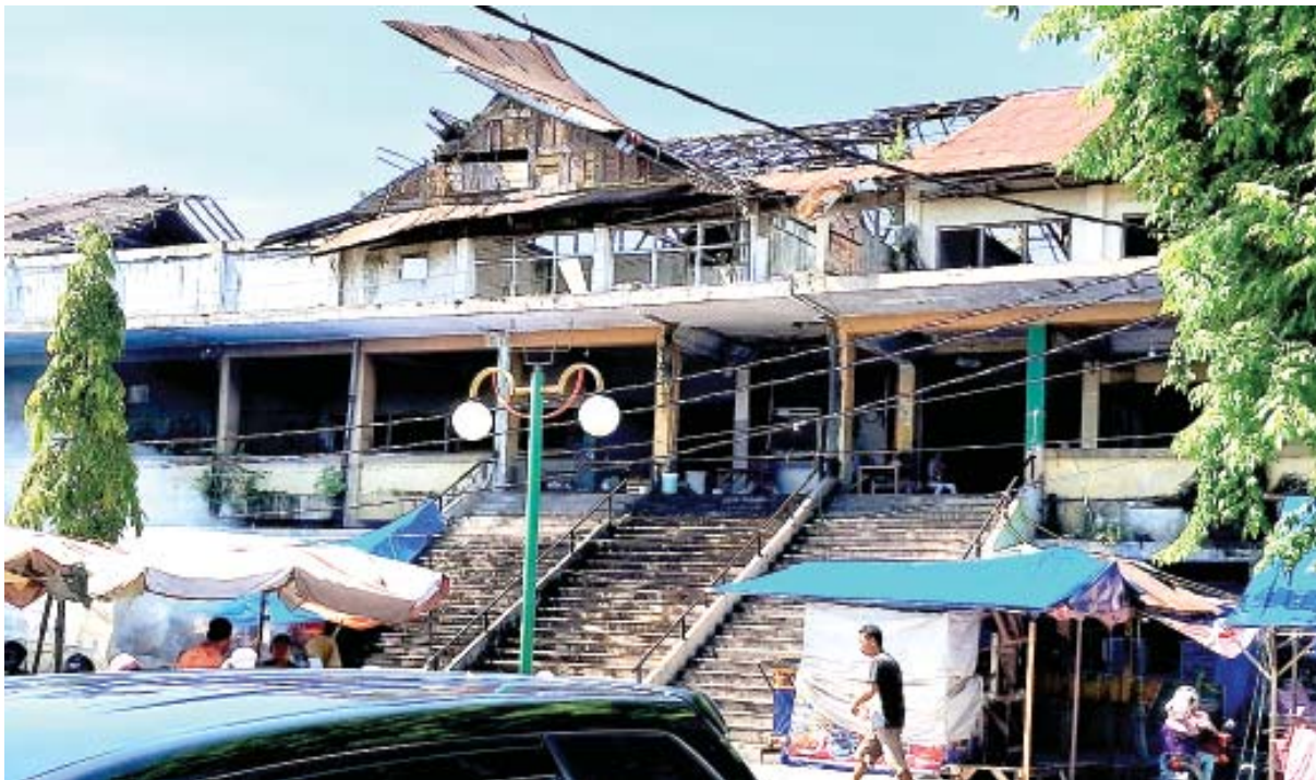
SANGAT MEMPRIHATIKAN | Kondisi bangunan Pasar Bertingkat, bekas Padang Teater di Pasar Raya Padang sangat memprihatinkan. Selain mengganggu pemandangan, bagian atap bangunan yang sudah lapuk, bisa mengancam keselamatan pengunjung. (Sawir Priyadi)
